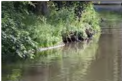
Foto: oever met metselwerk in verval
